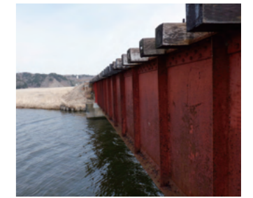
第6尾幌川橋りょう[経年] ○経年104年(1919(大正8)年完成) ○根室線 厚岸～茶内間
