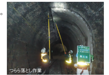
塩谷トンネル [経年、漏水の凍結など] ○経年110年(1913(大正2)年完成) ○函館線 塩谷～小樽間
