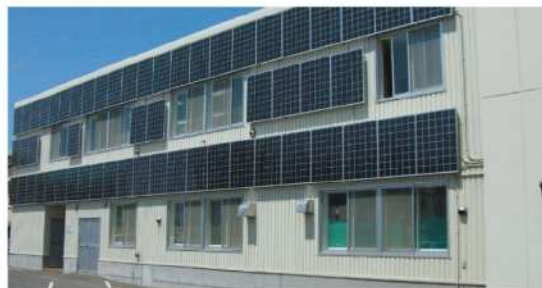
壁面設置の太陽光パネル
