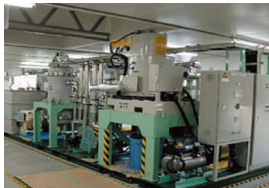
ワックス剥離廃液処理装置
