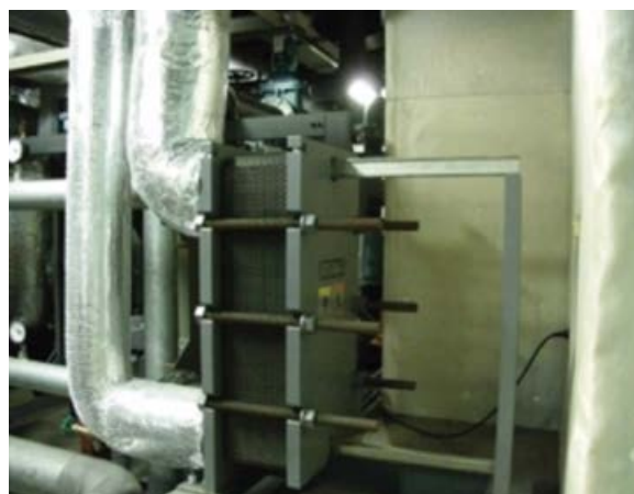
フリークーリングで使用する熱交換器
