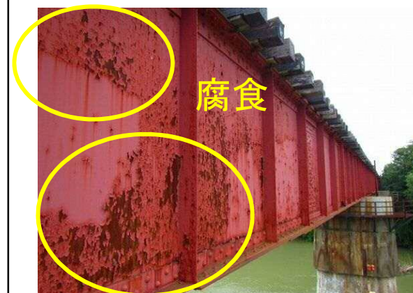
腐食が発生した橋りょう
