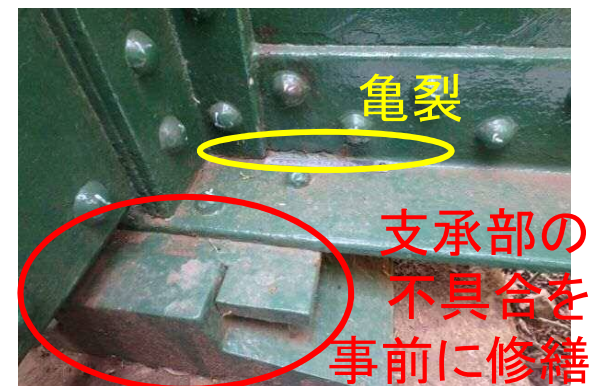
亀裂が発生した橋りょう
