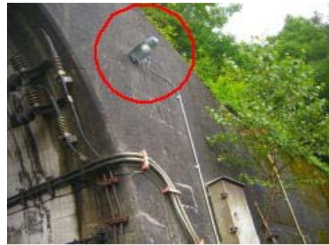
(トンネル出入口照明)
