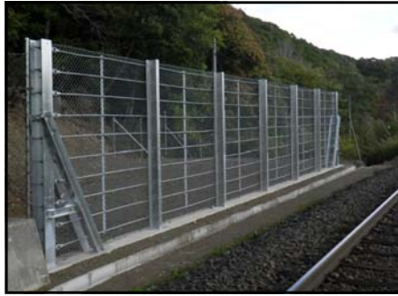
《落石・雪崩防護設備 石北線留辺蘂-相内間》
