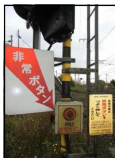
《踏切支障報知装置（非常ボタン）》
