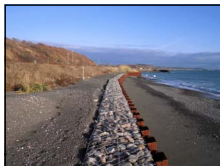
《護岸設備 日高線豊郷-清島間》
