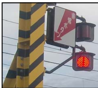
《全方向踏切警報灯》
