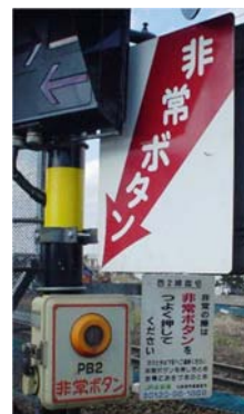
踏切支障報知装置 (非常ボタン)
