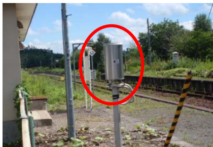
雨量計の増設
