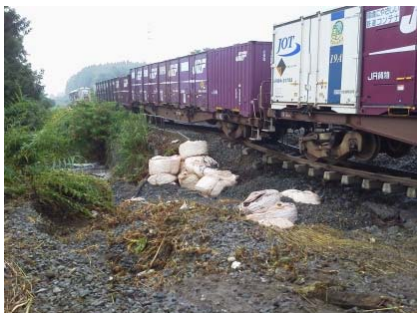
函館線山越～八雲間 熱田川氾濫・路盤流出状況
