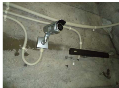
陸底部斜坑のカメラと放送設備
