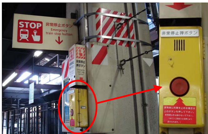
非常停止押ボタン
