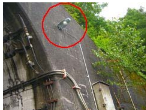
トンネル出入口の照明
