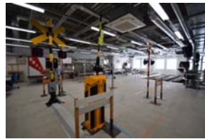
信号設備メンテナンスの実習や運転取扱い実習に使用する運転訓練室
