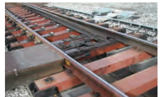
ポイント融雪ピット。今冬期は岩見沢駅構内の2ポイントに新設。
