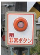
支障報知装置(非常ボタン)
